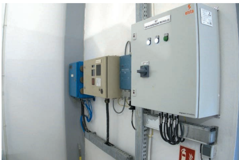
Rys. 7. Aparatura kontrolno-pomiarowa systemu „Venturon”
