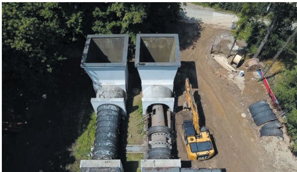
Rys. 1. Wentylatory głównego przewietrzania szybu „Wilson”
