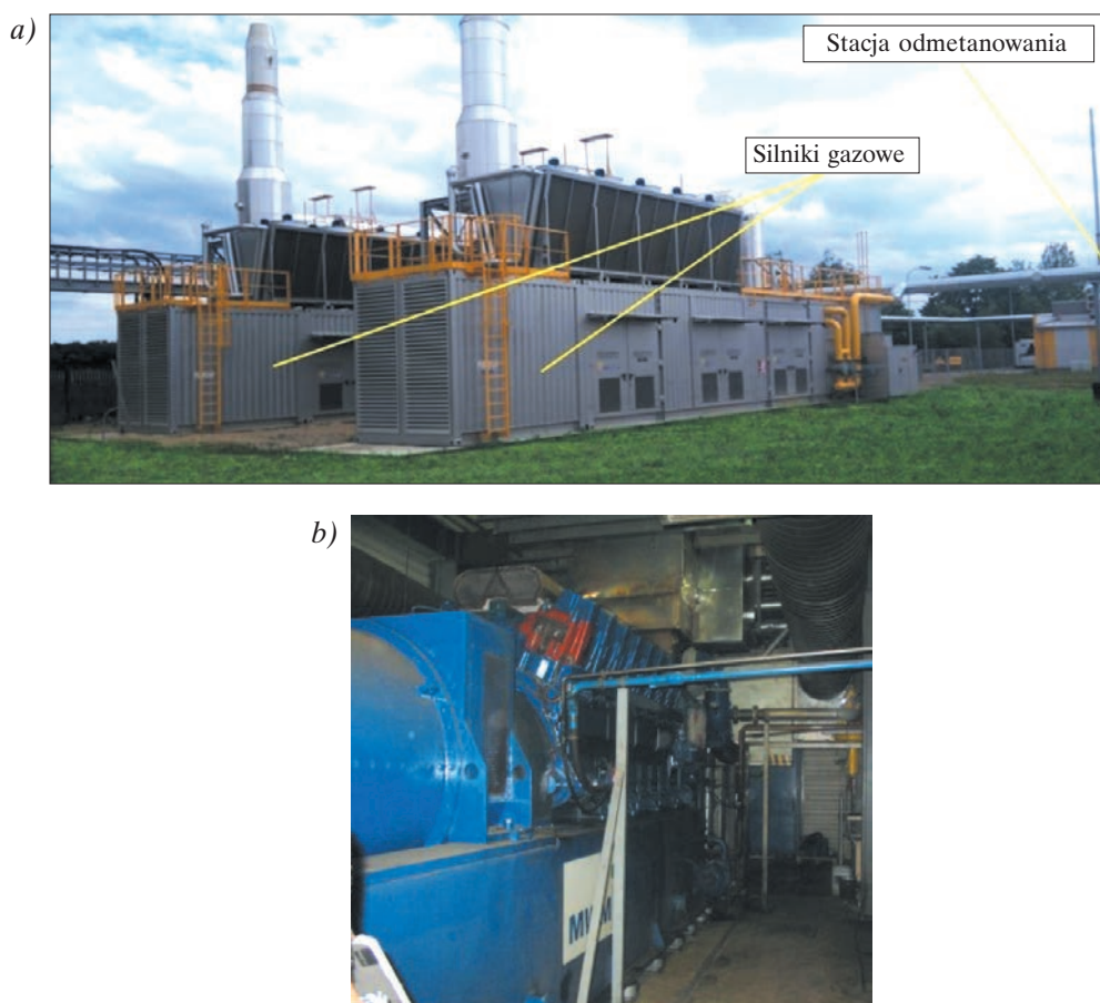
Rys. 6. System odmetanowania w kopalni „Pniówek”: a) stacja odmetanowania [14]; b) silnik gazowy
