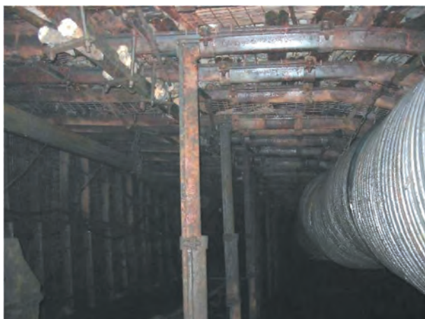
Rys. 19. Rozcinka rozruchowa zabezpieczona obudową ŁPro/B
