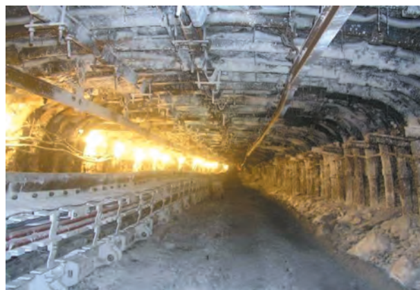
Rys. 40. Rozcinka ścianowa zabezpieczona obudową ŁPrP, wykonanie K
