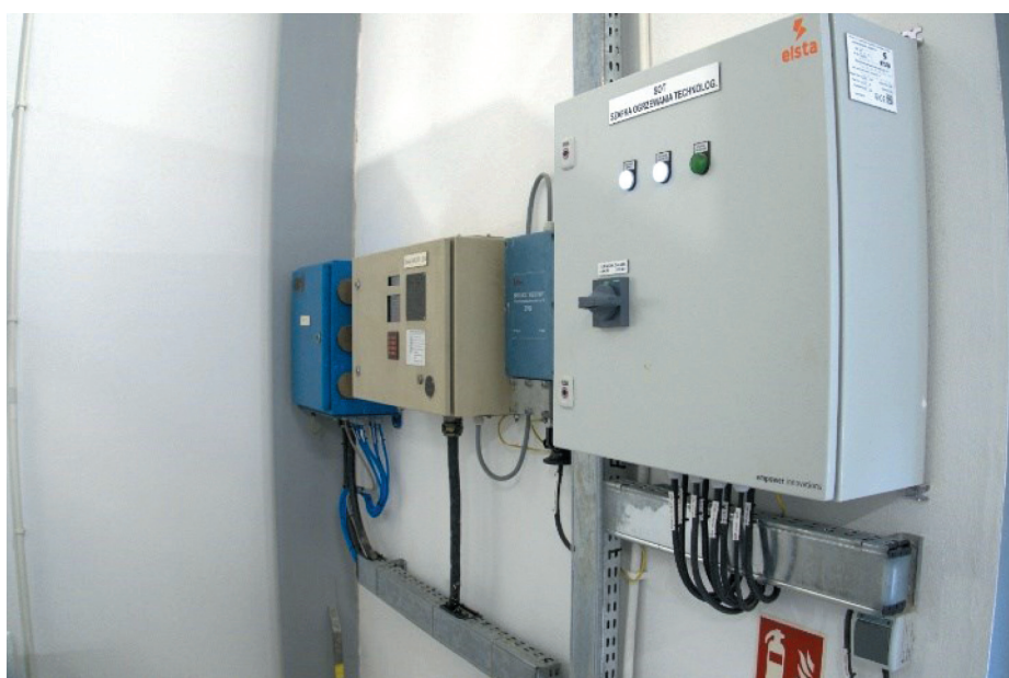
Rys. 7. Aparatura kontrolno-pomiarowa systemu „Venturon”
